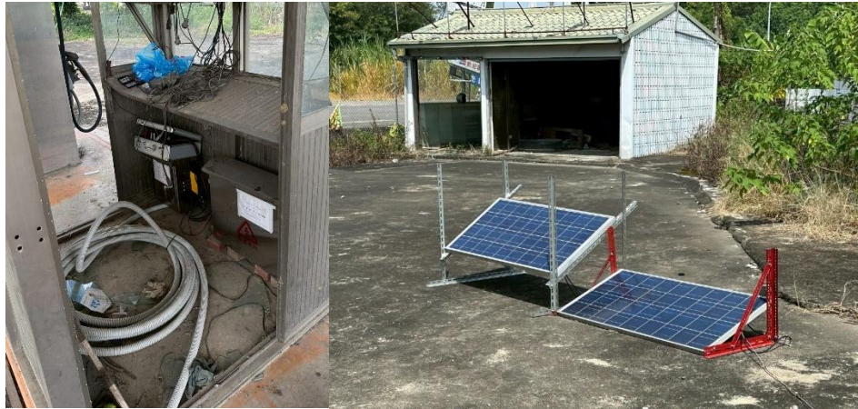
圖 55 TDR 回傳系統與太陽能供電設備
