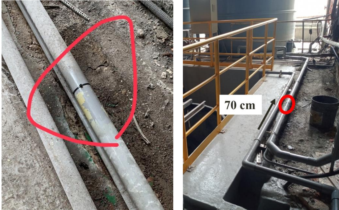
圖 34 現場滲漏事件發生位置
