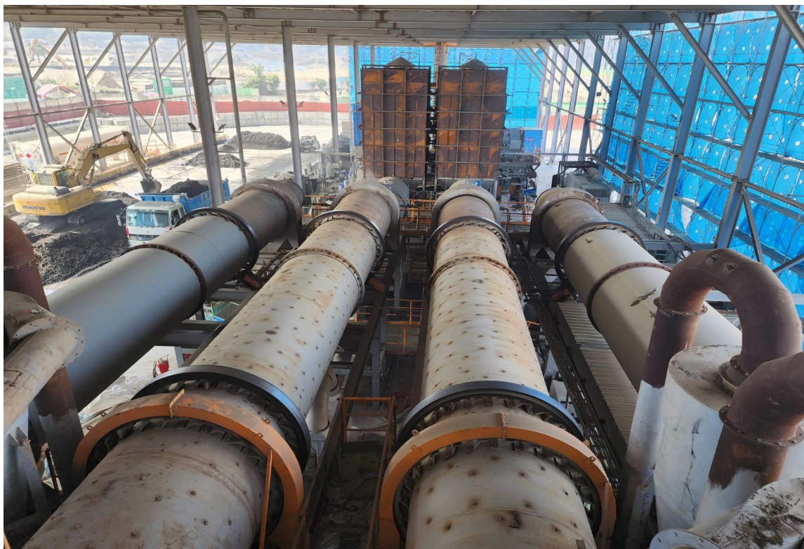
圖3-21. 現場熱脫附設備實體照片
