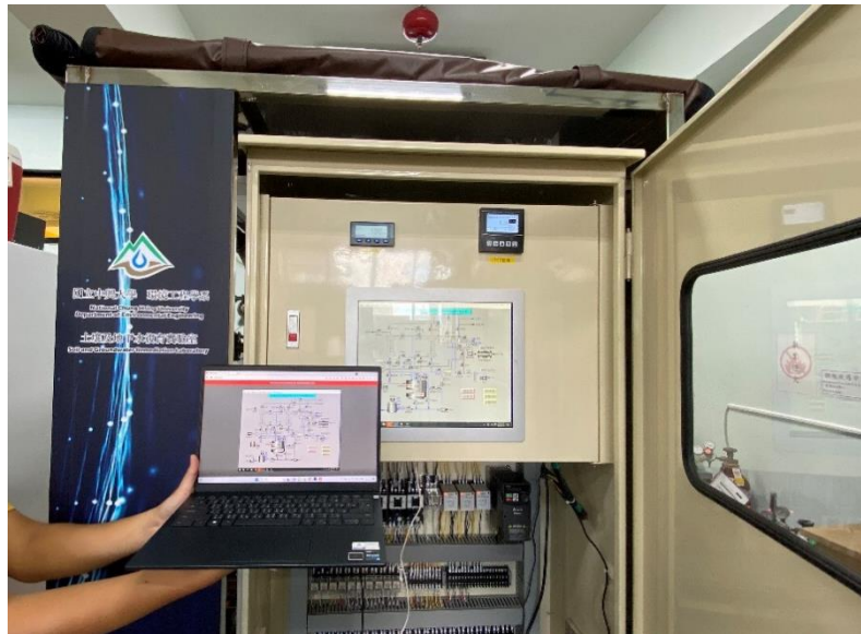
圖 十三、設備操作介面以及人機系統電腦遠端連線控制畫面
