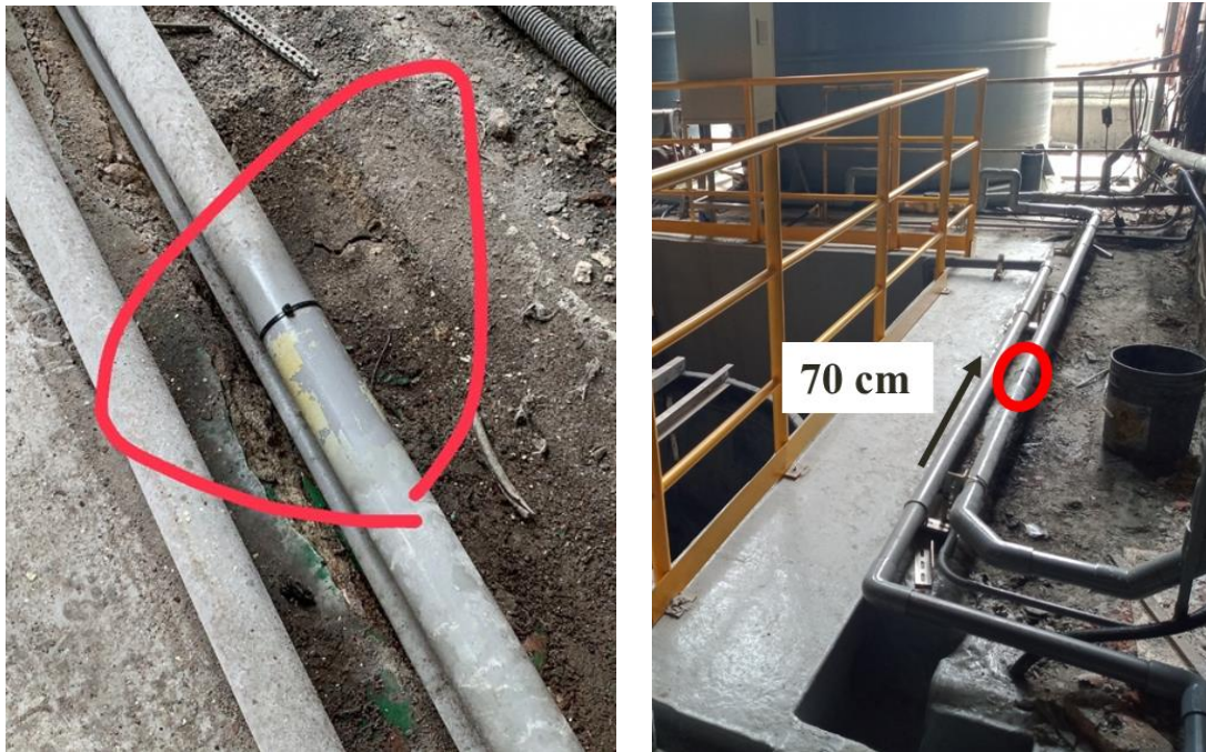
圖 33 現場滲漏事件發生位置
