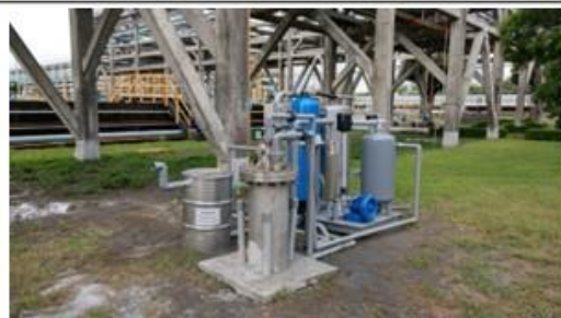
設備測試完成，正式試運轉
