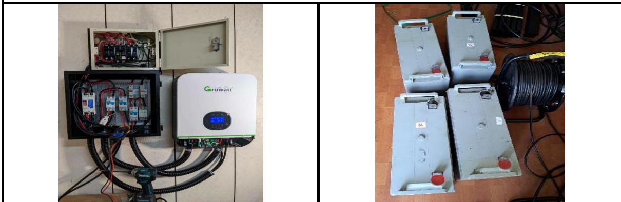
圖 47、綠能系統配電裝置(左)與蓄電池及電線設備(右)
