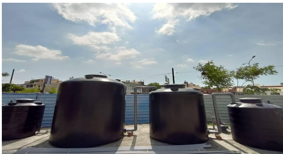
圖 2.5 本計畫廢水處理設施
