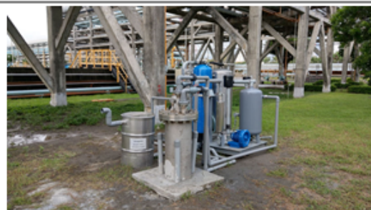
設備測試完成，正式試運轉
