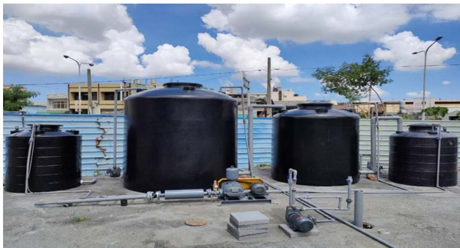
圖 3.13 廢水處理設施鼓風機設備完工
