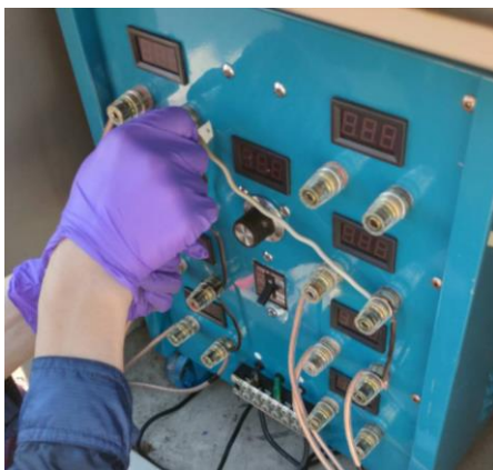
圖 35.整流器電線配置
