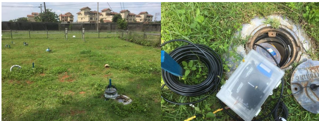
圖 37 中央大學井場設置遠距離監控地下水水位設備
